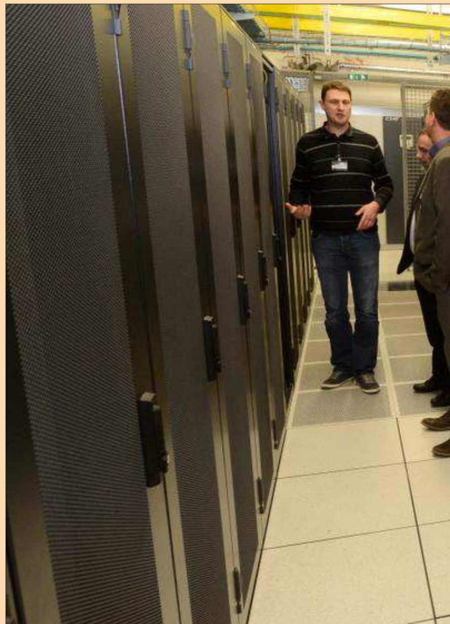
Les data centers (ici celui d'Hexanet à Reims) contiennent des dizaines de « baies » (armoires) où
